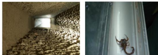
Figura 1 -Dutos de Ar.
