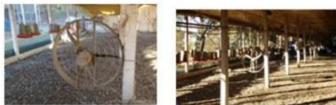
Fotos 1 e 2: Sistema de ventilação do aviário
