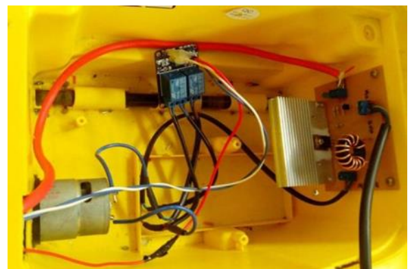
Figura 129 - Conversor Buck em conjunto com modulo relé (IFBA, 2017)
