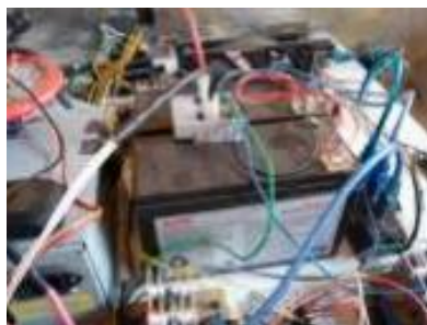
Figura 9 - Bateria utilizada para alimentar o protótipo
