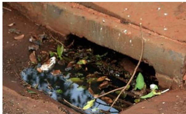
Figura 353 - Galeria entupida em cidade grande
