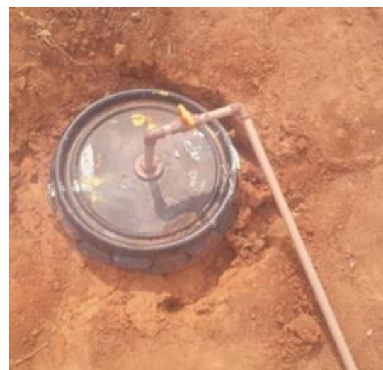
Figura 4 - Tanque de produção de biogás maior, enterrado. Fonte: Os Autores.
