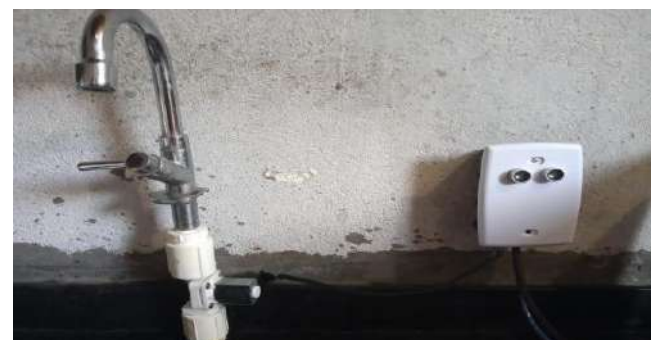
Figura 2 – Protótipo Instalado em teste (Fonte: do Autor).
