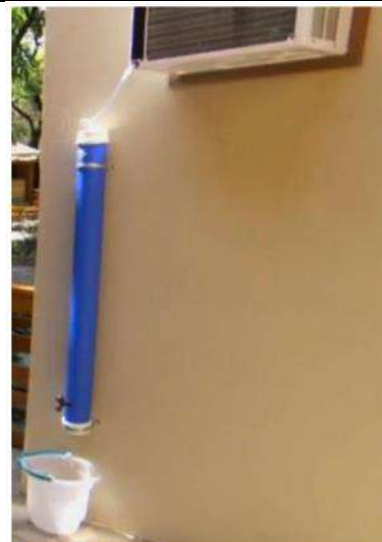
Figura 4 - Coletor fixado abaixo do ar-condicionado.
