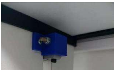
Figura 11 - Chave fim de curso instalada no elevador.
