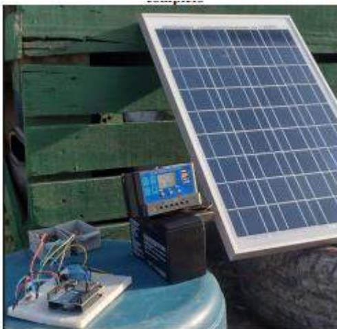
Figura 4 – Sistema de Irrigação Solar Automatizado completo
